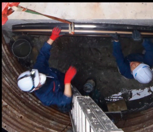
HP φ1800 フラット取付 ポンプ場既設吐口
